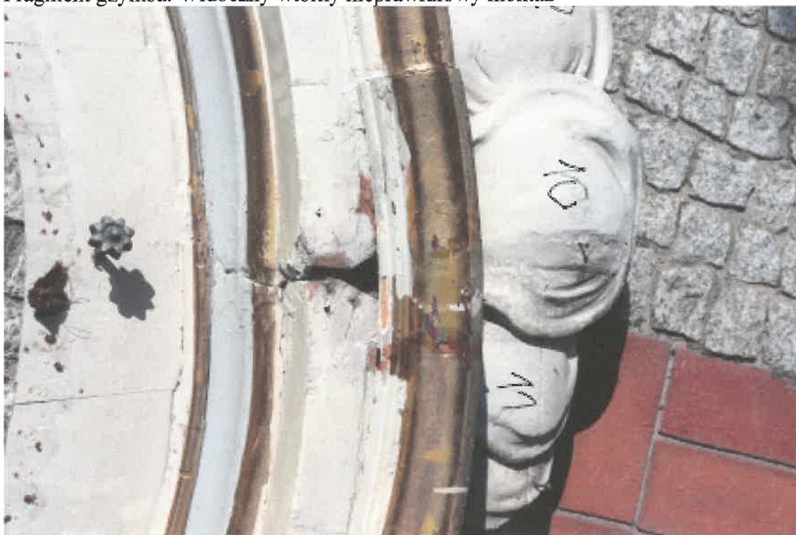
Fragment gzymsu. Widoczny wtórny nieprawidłowy montaż
